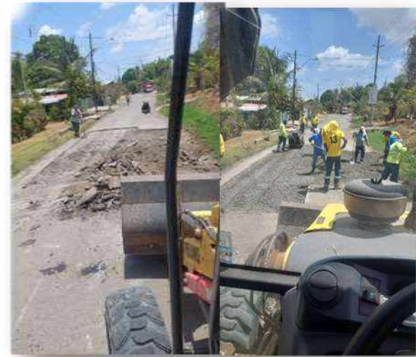
Retroexcavadora G10174: La Valdeza, calle de la Texaco, Guadalupe; levantamiento de cortes de asfalto, y limpieza de los mismos, se regaron 50 metros de capa base.
